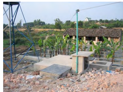
La station de traitement
